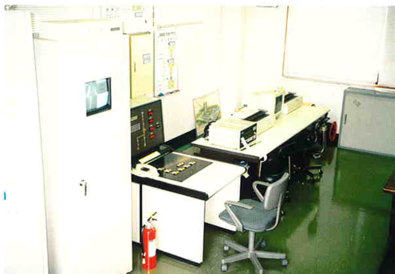
宮竹用水土地改良区事務所内にある上郷発電制御所
